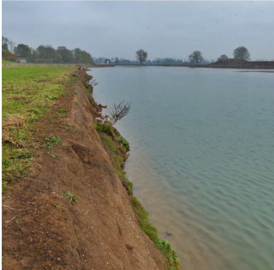
Foto 2.2: Oever van de nieuwe strang bij Maasbommel. Het steile profiel van de oever is niet conform KRW, maar volgens het principe van 'duurzaam beheer maatregelen' om vegetatieopslag te beperken (foto: Bureau Waardenburg).
