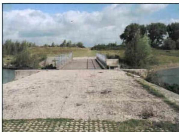
Erosie van toegangsweg en brug bij Gameren na aanleg (2000) en verbeteringsmaatregelen (2005).
